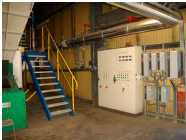
Modernizacja ciepłowni- nowy kocioł WR-8 wraz z szafą sterowniczą
