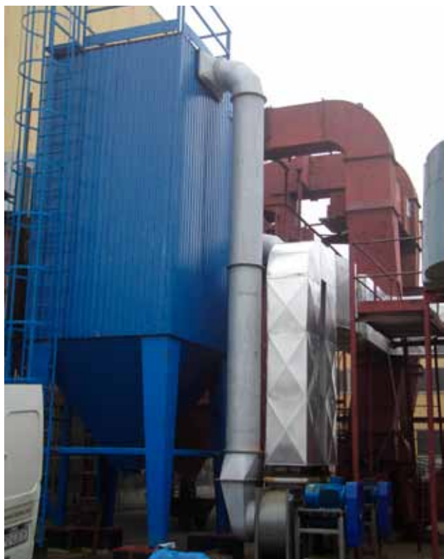
Modernizacja ciepłowni- nowy układ odpylania
