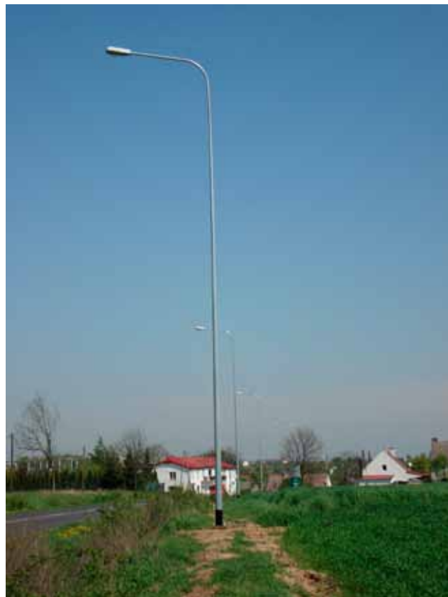
Oświetlenie drogowe w Moczowie
